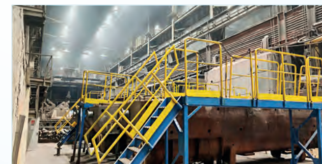
Стационарные площадки для обслуживания промковшей
